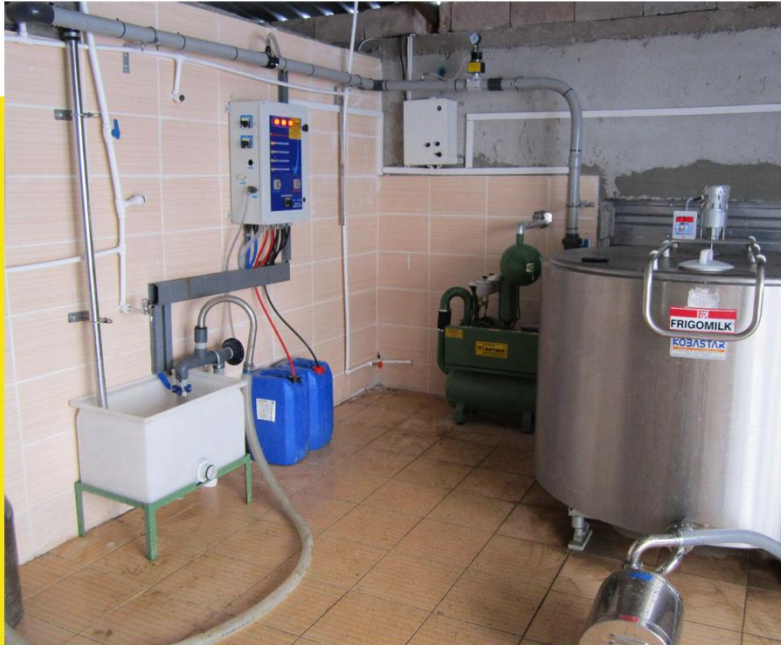
POMPA VE SOĞUTUCU DAİRESİ UNITÉ DE POMPAGE ET SALLE DE REFROIDISSEMENT DU LAIT
